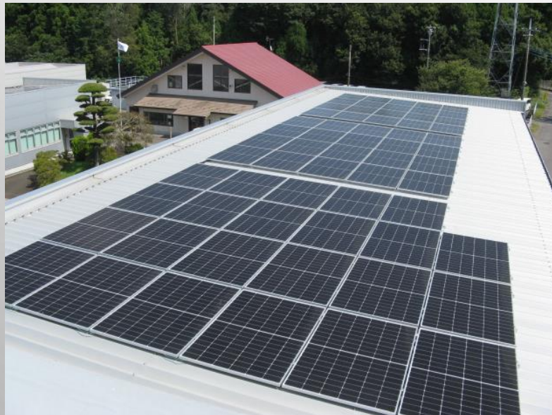
[茨城工場(パネル設置箇所の一部)]
